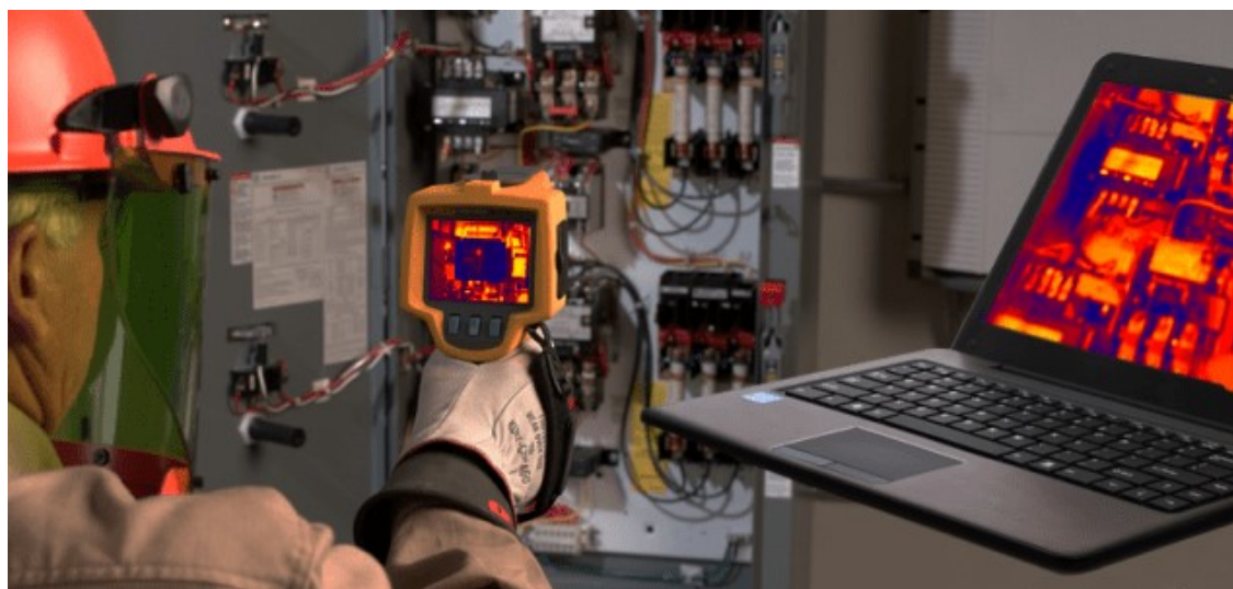
Рисунок 20. Пример проведения тепловизионного контроля электрошкафа
